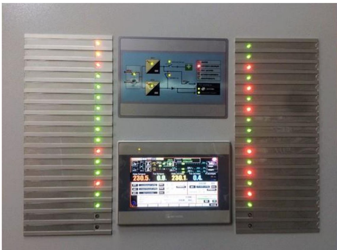
Светодиодная панель на дверях типовых шкафов ВЗУ, ШРОТ.
